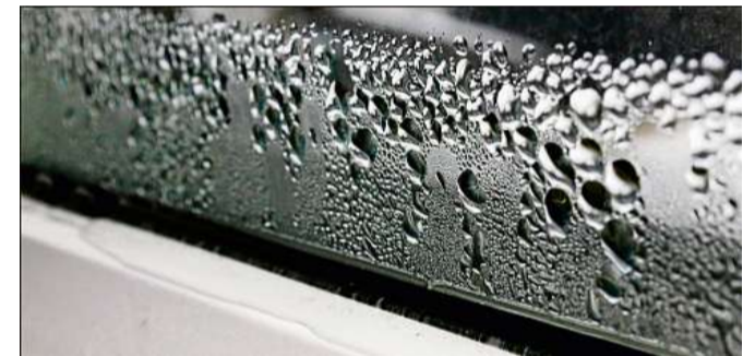
Kondenswasser an Fensterscheiben sind oft ein deutliches Zeichen dafür, dass sich durch den Einbau moderner Kunststofffenster viel Heizenergie sparen lässt. Foto: Amelia Martin/123rf/Veka
